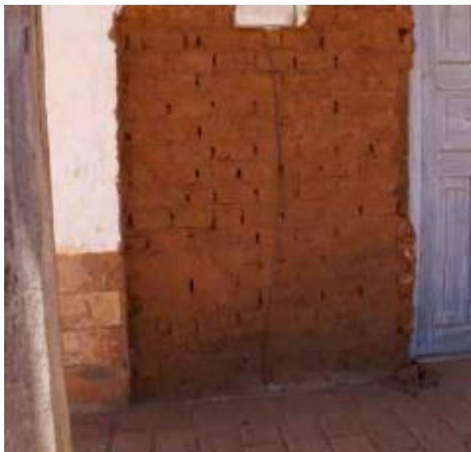
Figura 17. Paredes de Adobe con desprendimiento del reboque
